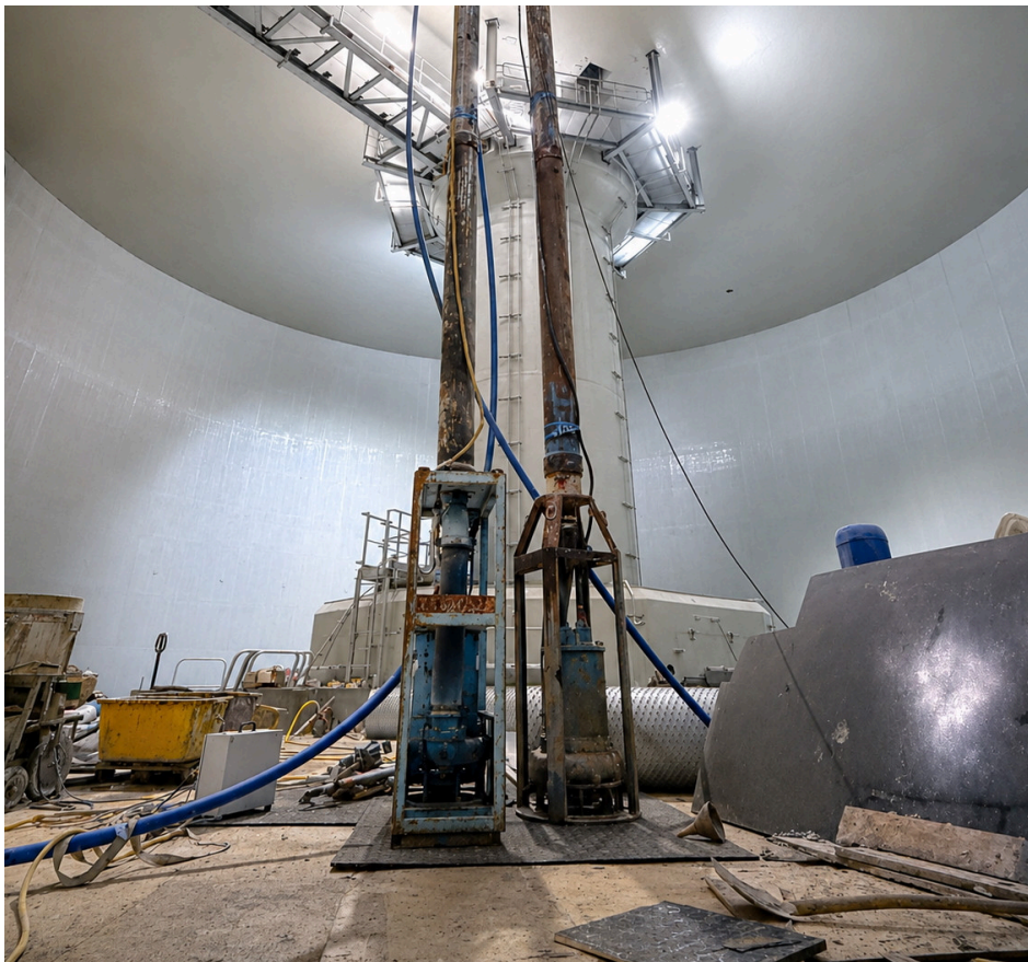
Zwei »GPN622«-Pumpen vor der Testflutung des Regenüberlaufbeckens (Bild:
