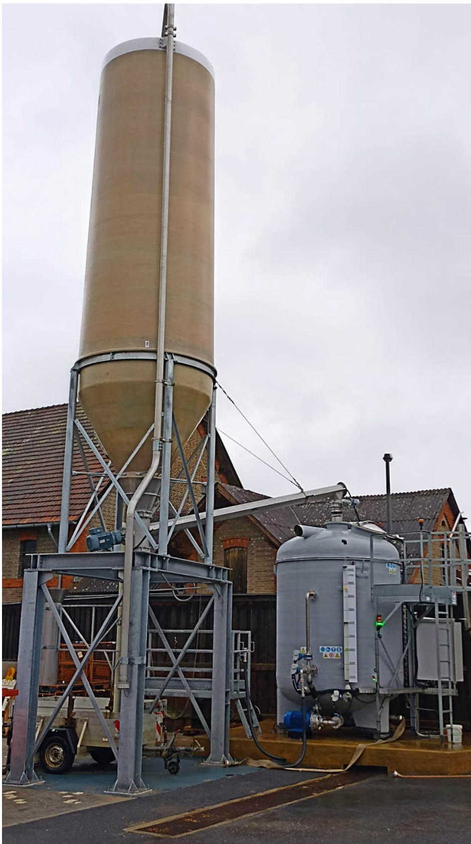
Soleerzeuger »Speed Brine« mit Wägezellen zur vollautomatischen Aufbereitung von Sole in der Stadt Sulzbach-Rosenberg (Bild: Agristrade).
